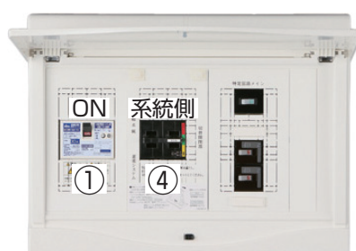
蓄電分電盤セットH
